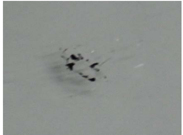
nicht fachgerecht instandgesetzt/ Lufteinschlüsse vorhanden
